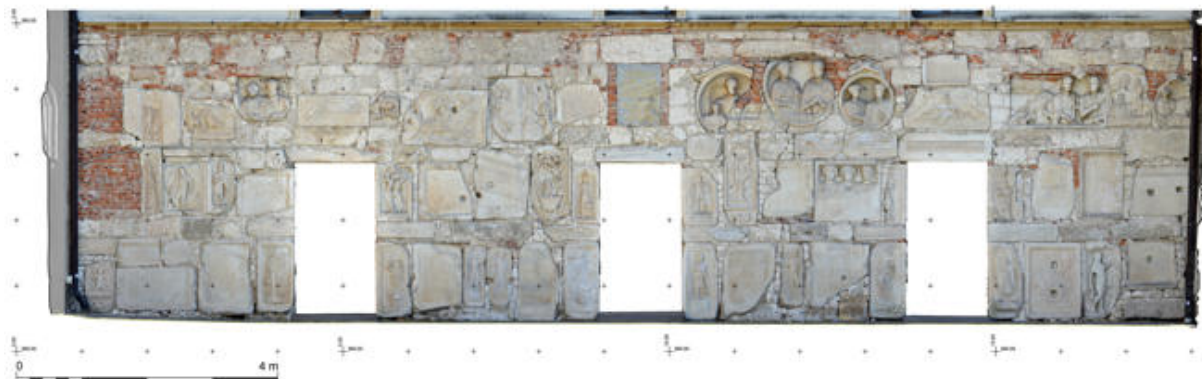
Abb.: Die unverputzte Westseite der Römersteinwand im Schloss Seggau, Orthoansicht auf Basis des Laserscans und des Structure-from-Motion (© P. Bayer, St. Karl)
